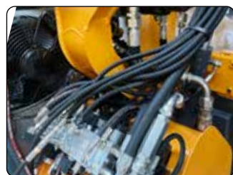
Nuovo sistema idraulico. New hydraulic system.
